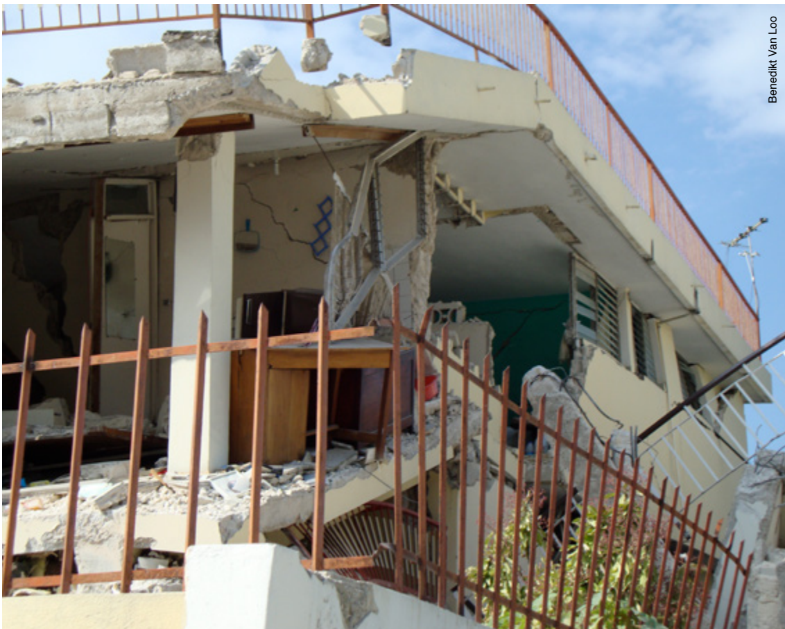
Zerstörte Gebäude in Haiti nach dem Erdbeben 2010
